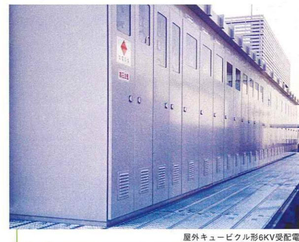
屋外キュービクル形6KV受配電盤
