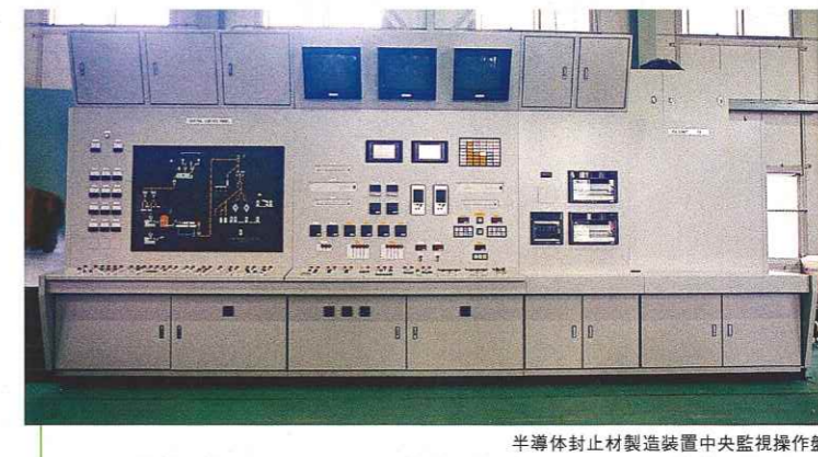
半導体封止材製造装置中央監視操作盤
