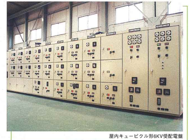
屋内キュービクル形6KV受配電盤
